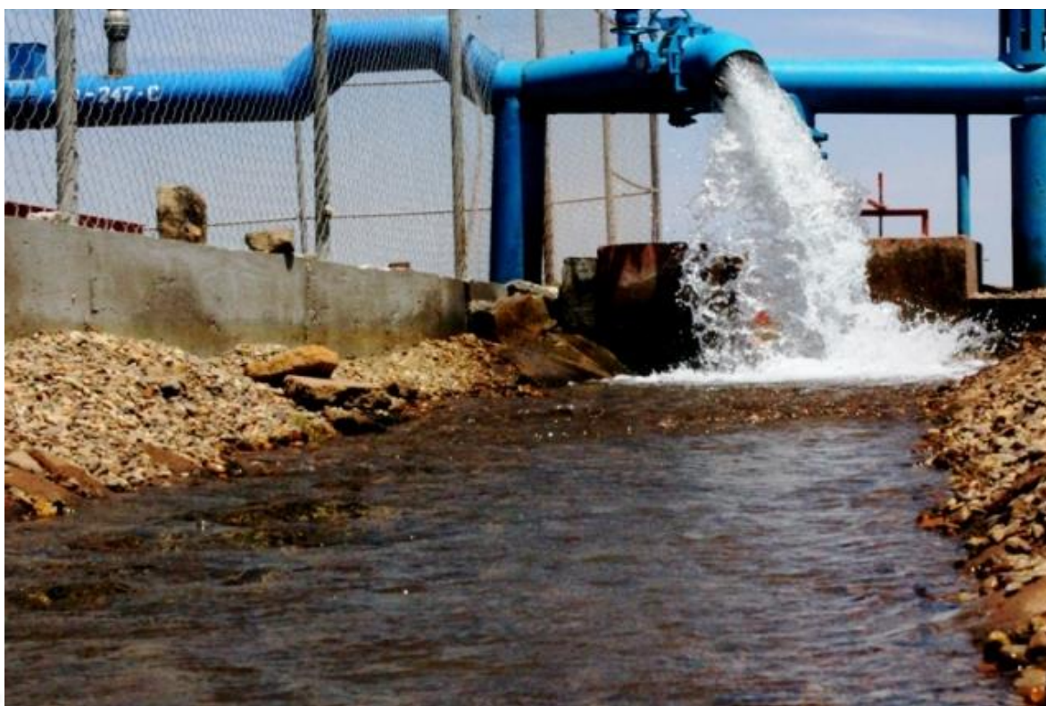
Toma de agua potable en el Valle de Mexicali
