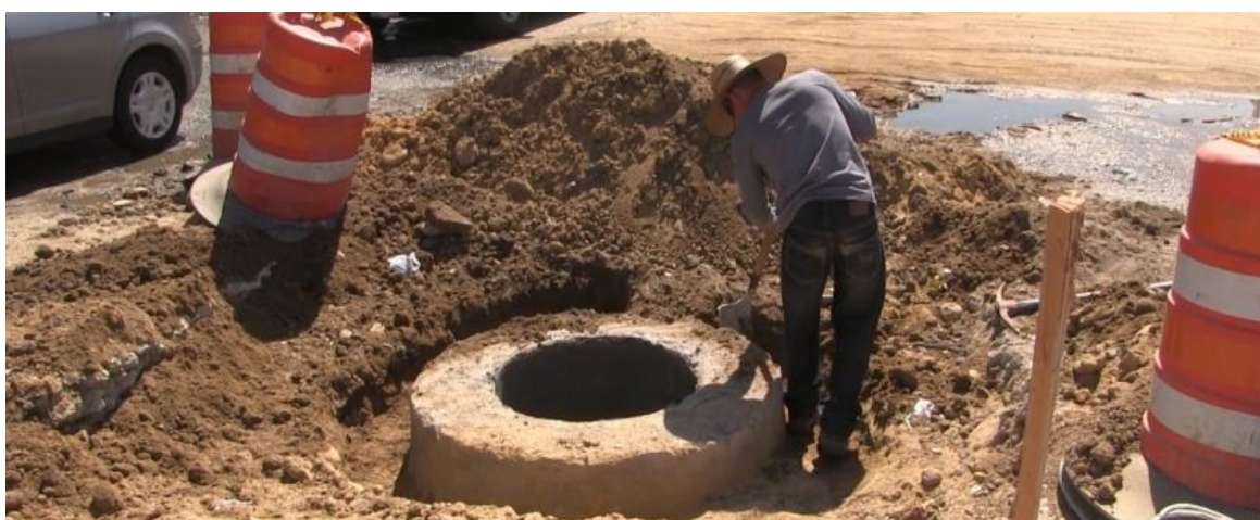
Obra de Alcantarillado Sanitario en la ciudad de Tijuana. Pozo de visita
